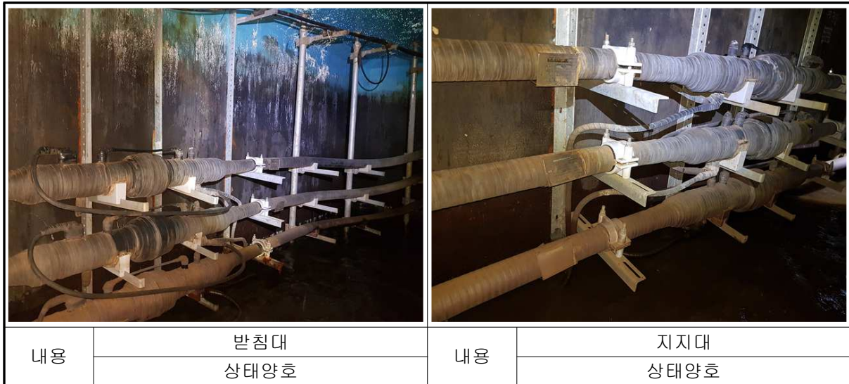
【사진 11.24】 부속 및 부대설비 현황
