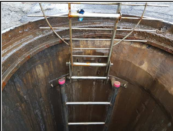
내용 추락방지시설 앵커볼트 파손
