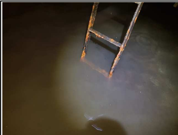
내용 추락방지시설 사다리 하부 고정볼량
