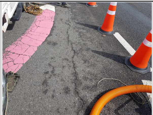
내용 도로포장 아스콘균열
