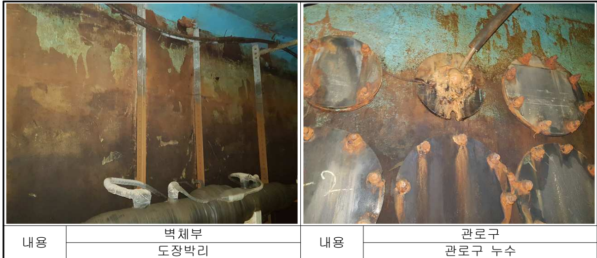
【사진 11.14】 맨홀 내부 주요 손상
