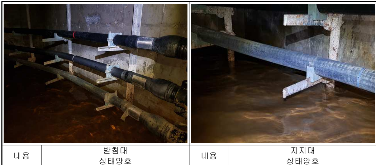
【사진 11.48】 부속 및 부대설비 현황
