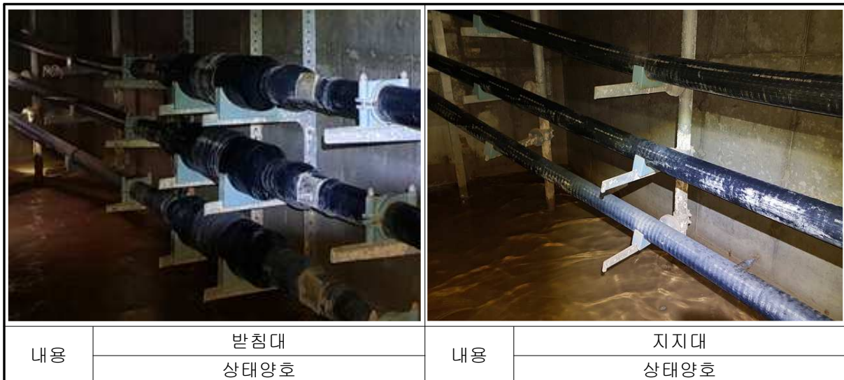
【사진 11.52】 부속 및 부대설비 현황
