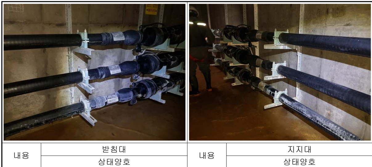
【사진 11.60】 부속 및 부대설비 현황
