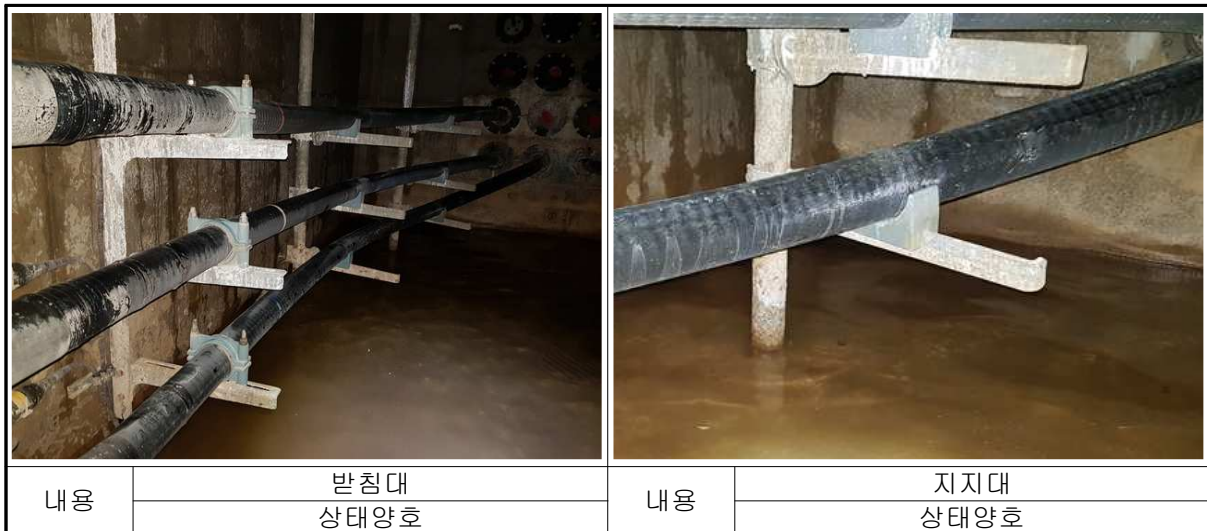
【사진 11.68】 부속 및 부대설비 현황
