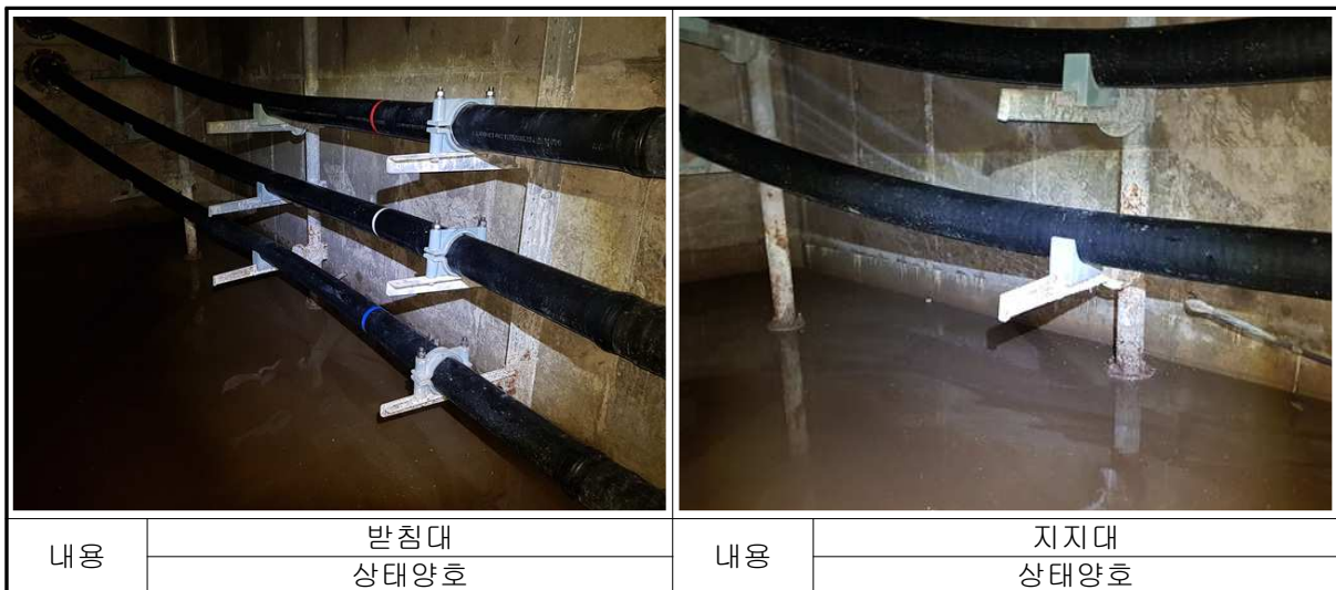
【사진 11.72】 부속 및 부대설비 현황
