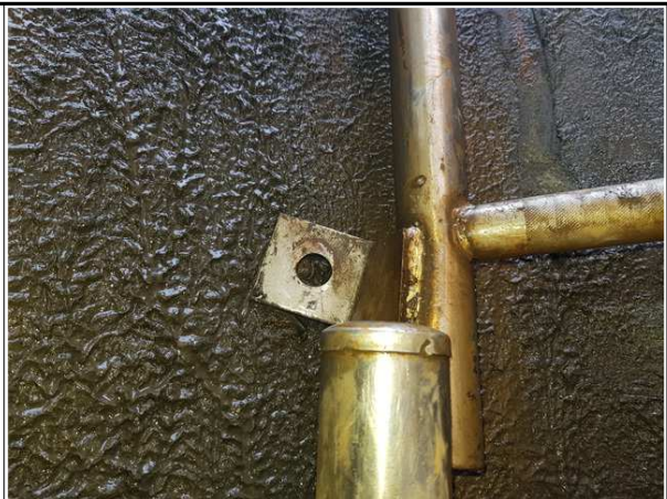
내용 추락방지시설 안전사다리 볼트탈락
